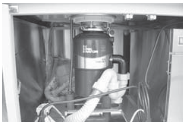
流しの下に設置されたディスポーザー
