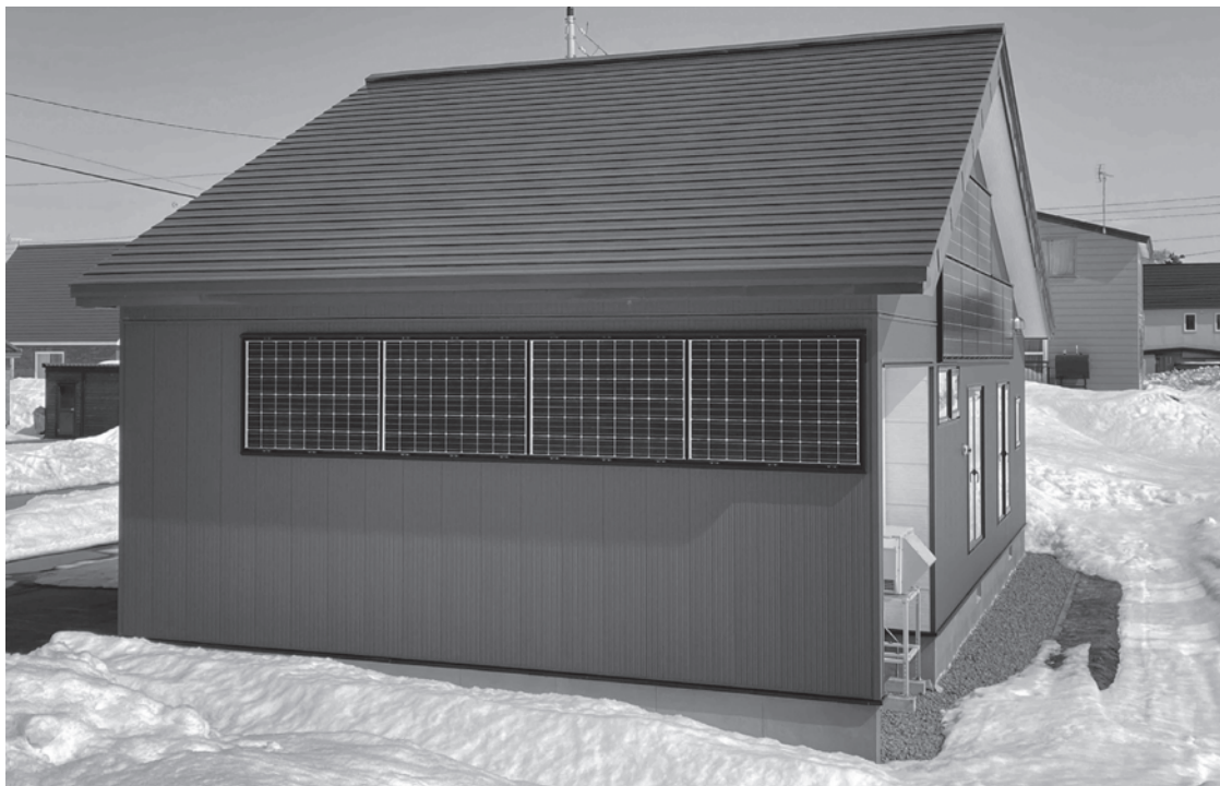
▲沼田町が(株)カネカとの連携で発電実績を調査している再生可能エネルギー（壁面設置型太陽光パネル）の活用
