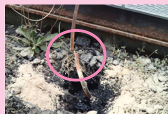
▲ 配管が切断され灯油が漏れている
