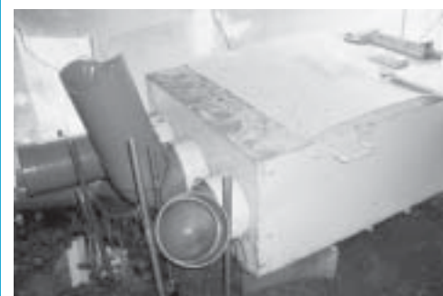
冷房運転中の熱交換器
