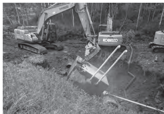
導水幹線の破損状況
