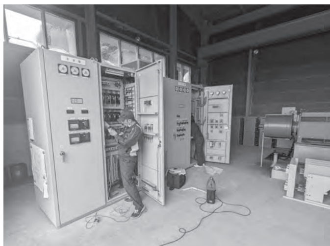
故障した共成揚水機場の制御装置
