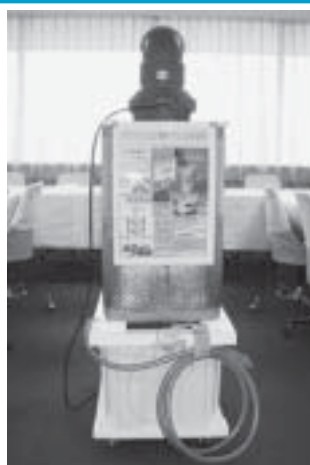
会議室に設置された雪冷房機
