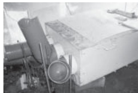
冷房運転中の熱交換器
