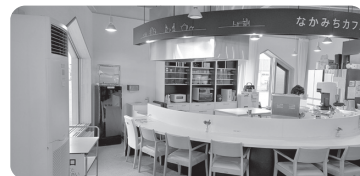
なかみちカフェに設置された冷房
